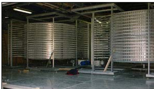
Instalación de espiral con tambor doble
